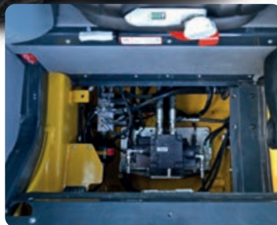
Gracias a la compuerta interna de la cabina, el mantenimiento extraordinario del distribuidor puede hacerse rápidamente sin necesidad de bascular la cabina.
